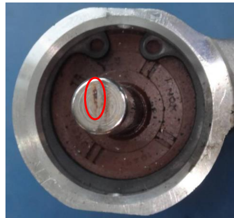
Отметина на штоке гидронатяжителя
