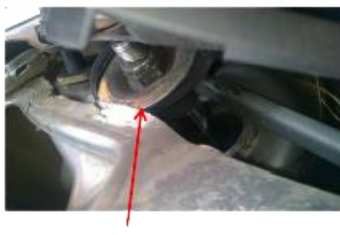
Опора плохого качества
