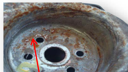
Koroze způsobené pohybem pružiny
